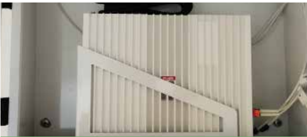
万兆光纤交换机入室部署
